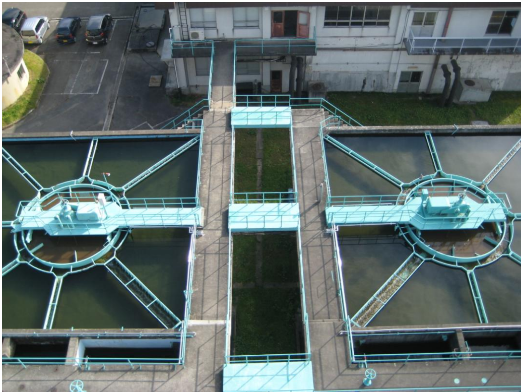
最上川中部水道企業団 高速沈澱池
