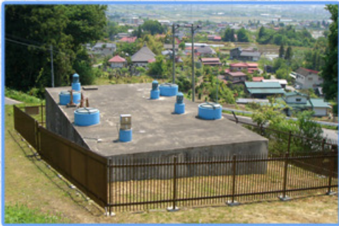
⑤ 村木沢配水池
